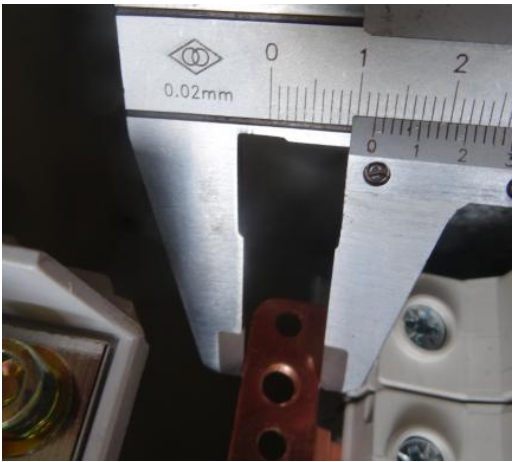
主母排宽度照片
