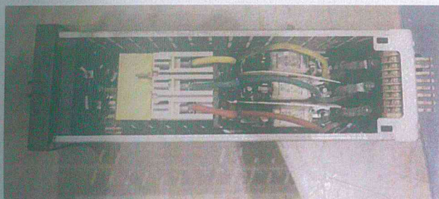
出线 1 抽屉照片
