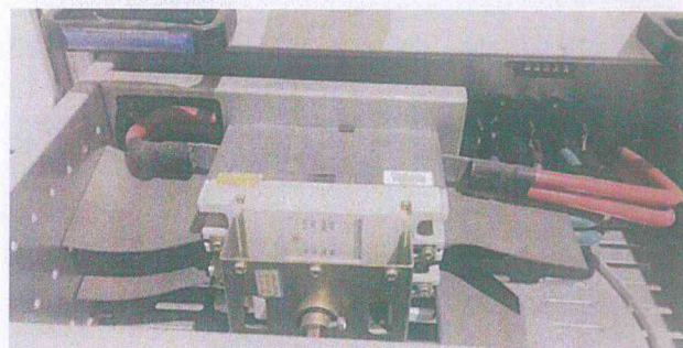
出线 8 抽屉照片
