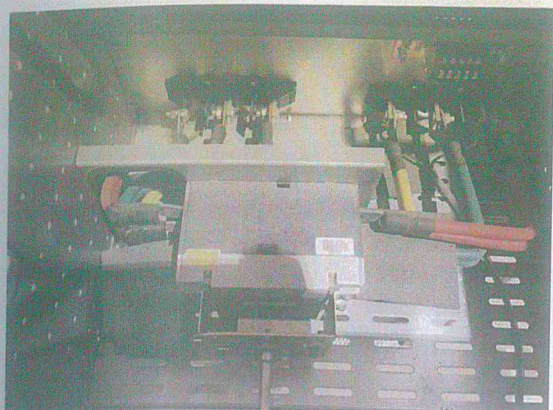
出线 9 抽屉照片
