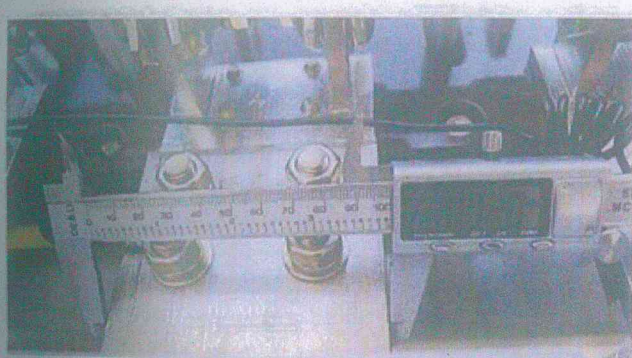
主开关出线母排宽度
